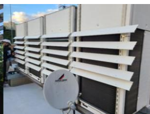
室外機の省エネ
